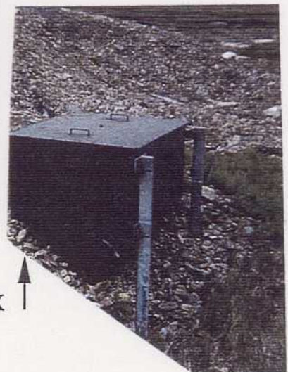
ELECTRIC CONDUIT BOX
